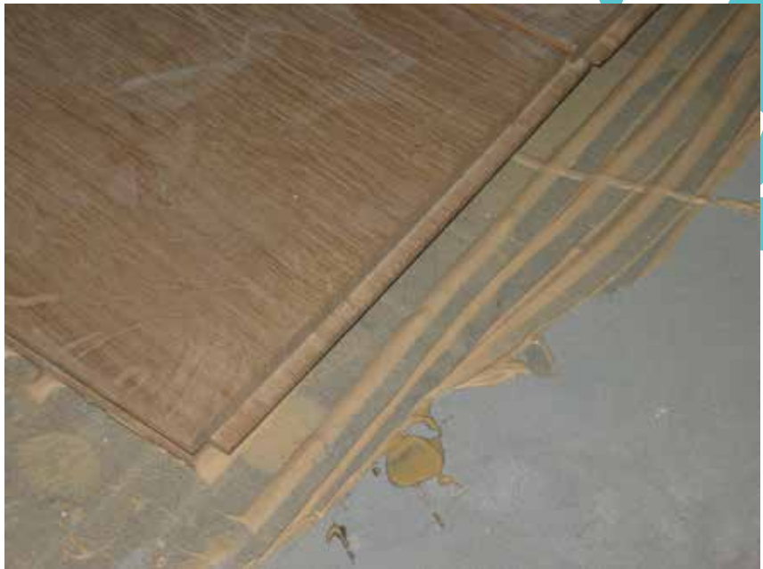
Fig. 1 La nature de la colle a une réelle influence sur l'isolement aux bruits de choc des planchers.
