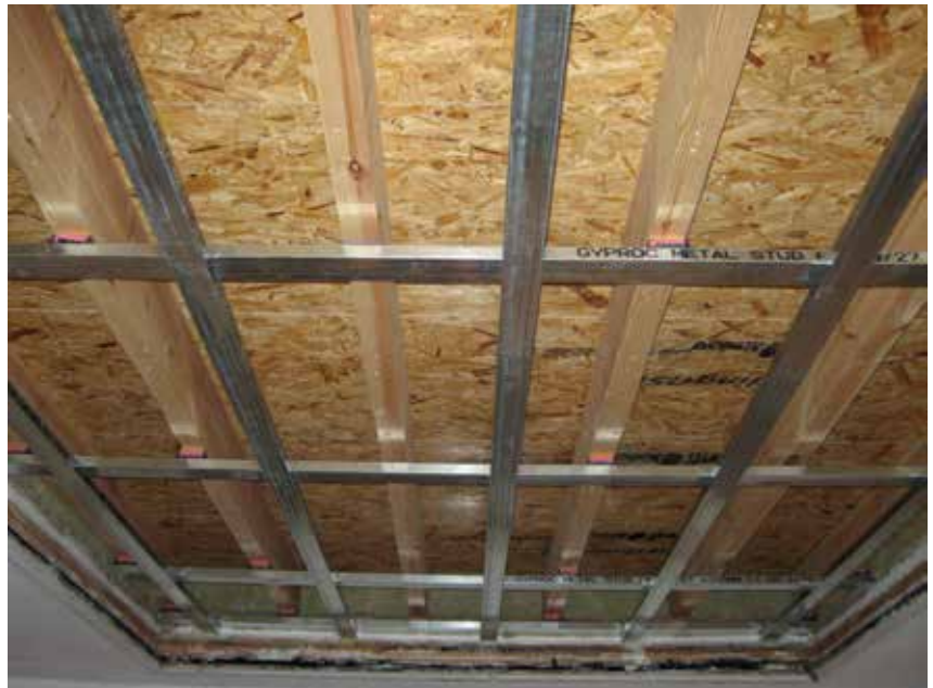
Fig. 3 Puisque un plancher en bois ne peut rester apparent entre deux habitations, un plafond suspendu devra compléter l'isolation acoustique.
