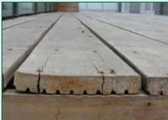
Fig. 1 Fissuration au droit des points de fixation
