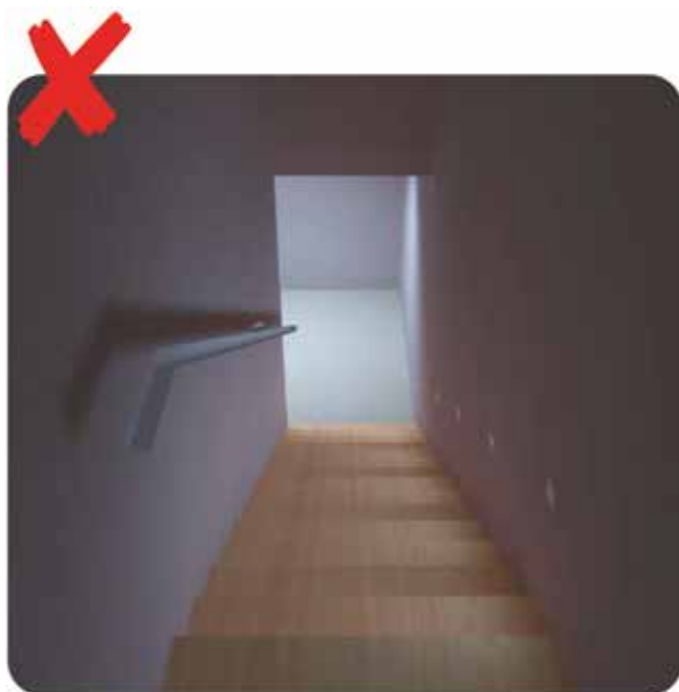
Fig. 3 Spots intégrés dans le mur (un spot pour trois marches). Certaines marches (notamment les marches 4 et 5 en partant du haut) sont éclairées de manière assez uniforme, ce qui les rend plus difficiles à distinguer les unes des autres.
