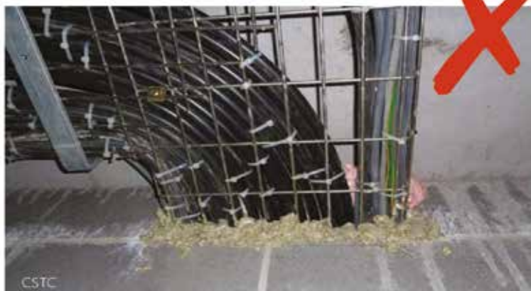
fig. 1 | Mauvaise exécution d'une traversée de paroi résistant au feu par un chemin de câbles au moyen de mousse PU.
