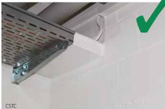
fig. 2 | Exécution correcte d'une traversée de paroi résistant au feu par un chemin de câbles.
