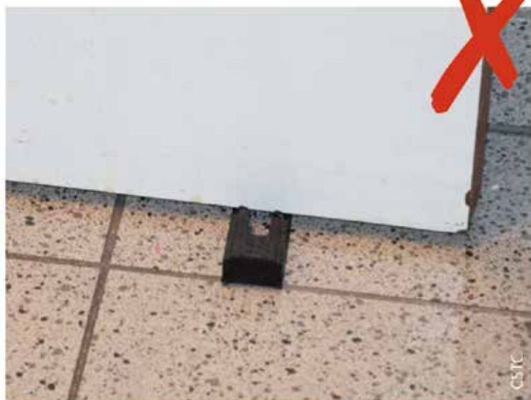
fig. 2 | La fermeture automatique de la porte a été volontairement bloquée.
