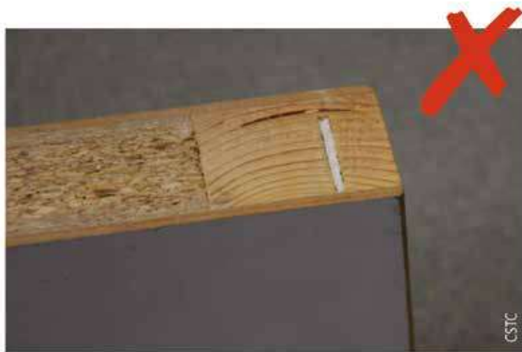
fig. 1 | La traverse supérieure du vantail et son produit intumescent ont été totalement rabotés
