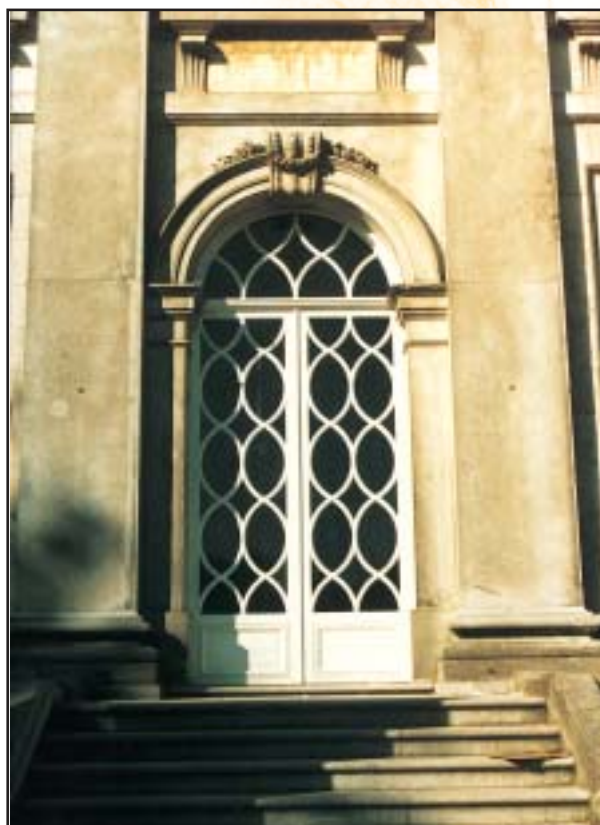
Château de Seneffe. Restauration, selon les règles du nombre d'or, d'une double-porte en bois de chêne avec des croisillons en bois massif.
